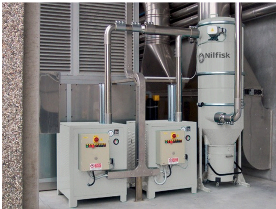
Sistema de aspiración centralizado en una empresa química: 2 unidades de aspiración, 1 silo de filtro.
